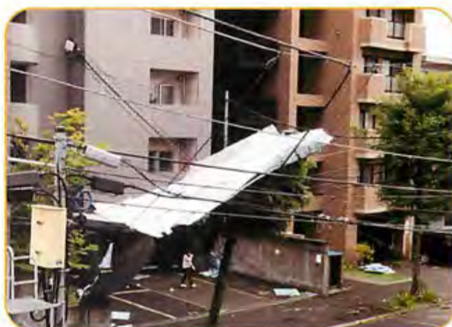
台風による被害
