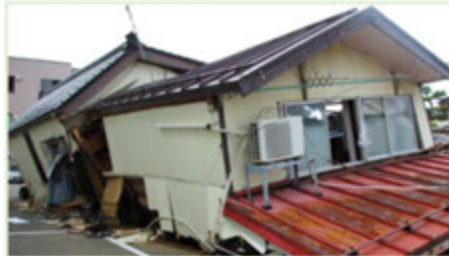
2007年 新潟県中越沖地震 写真提供:首都大学東京 都市環境学部
